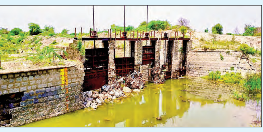
నింబగల్లు గ్రామం 181వ కిలోమీటరువద్ద హెచ్ఎలీసీ రెగ్యులేటర్ కట్టడం రాళ్లు ఊడిపోయిన అధ్యాన్నంగా ఉన్న దృశ్యం
